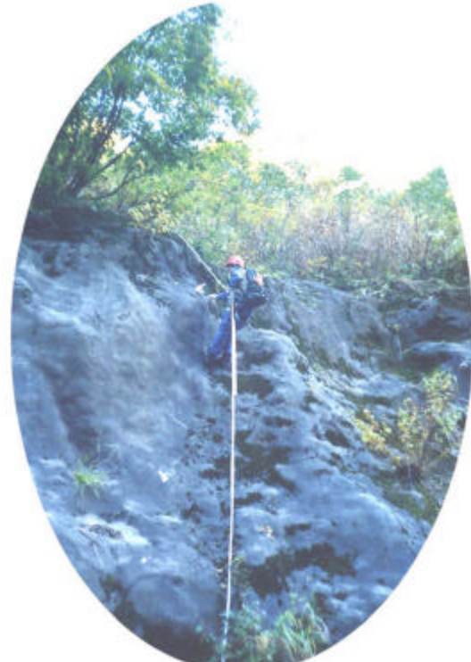
モルタル吹付のり面で目視による調査・打音調査・シュミットハンマーによる調査もしています。
